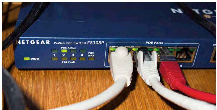
Versorgt wird das Ganze von einem PoE-Switch
